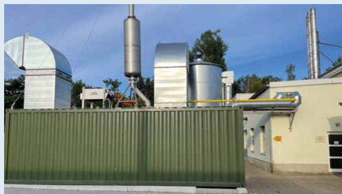
Das BHKW hat eine Gesamtfläche von 30 m 2 .
